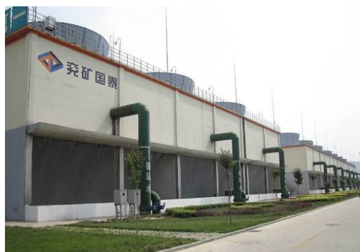
兖矿国泰化工有限公司（山东·滕州） 10 台 NH-4500 型冷却塔
