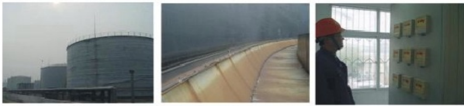
镇海国储库应用
