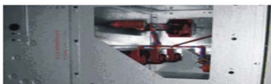
开关柜内光纤光栅传感器应用
