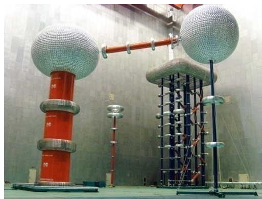
3600kVA/1800kV 工频试验变压器系统
