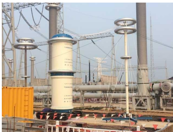
3000kV/300kJ 大容量 GIS 现场陡前沿冲击试验装置（SF 6 气体绝缘）
