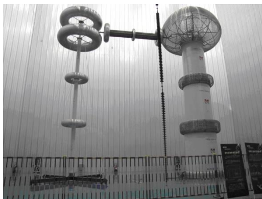
1650kVA/1650kV 工频试验变压器系统
