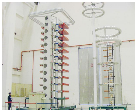
2400kV/360kJ 冲击电压试验系统
