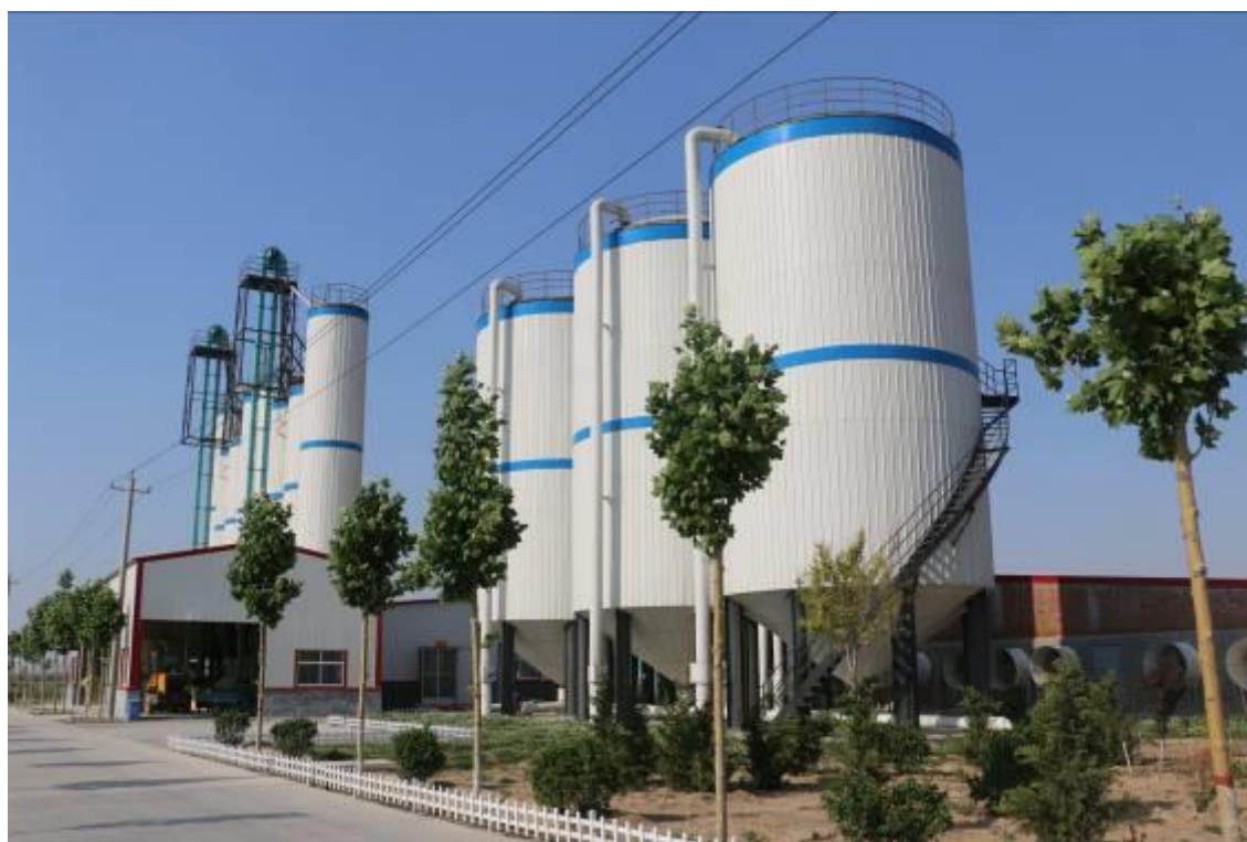
图 3 原料储存设备
