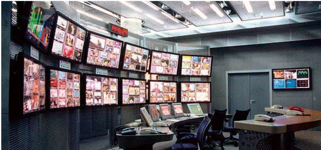
国家新闻出版广电总局监管中心有线数字电视监管项目
