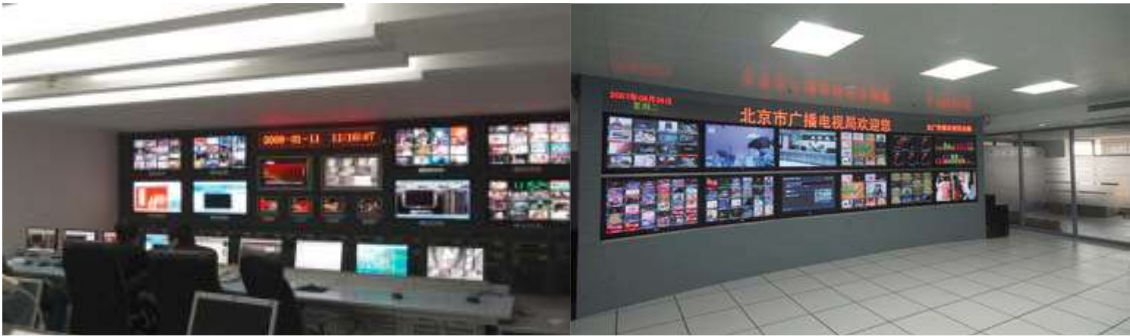
江苏省广播电视监测台广播电视安全播出监 测系统 北京市广播电视监测中心高清及鼎视平台电 视监测系统项目
