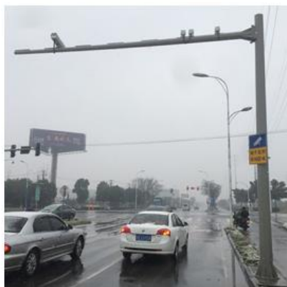
电子警察前端监控设备
