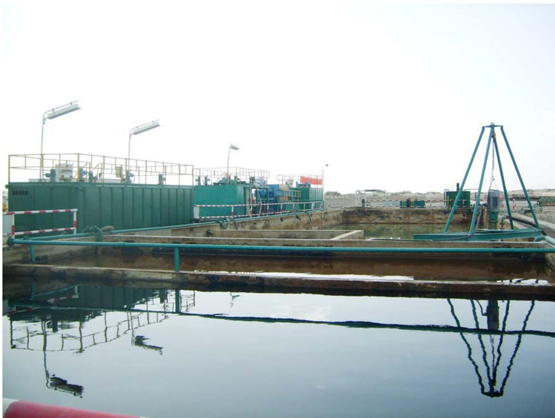
中石化西北塔河油田压裂返排液处理站
