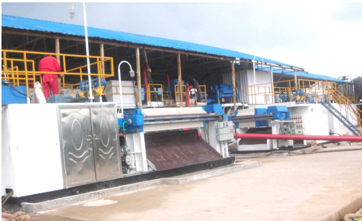
西南元坝六井单井废弃钻井泥浆随钻不落地处理站
