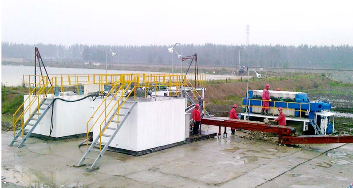
中煤集团废弃钻井泥浆随钻不落地处理站
