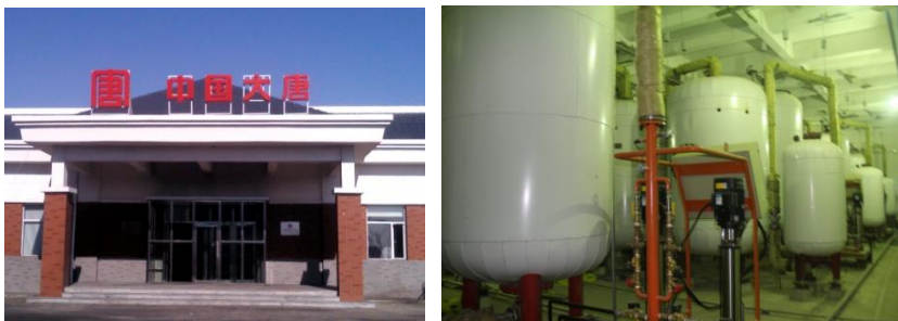
图 2.2: 电力负荷自动平衡系统实景图
