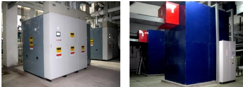
图 2.6: 冷热双蓄系统实景图
