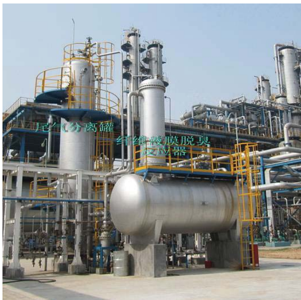
山东齐旺达石化公司 30t/h 催化汽油纤维液膜脱臭装置
