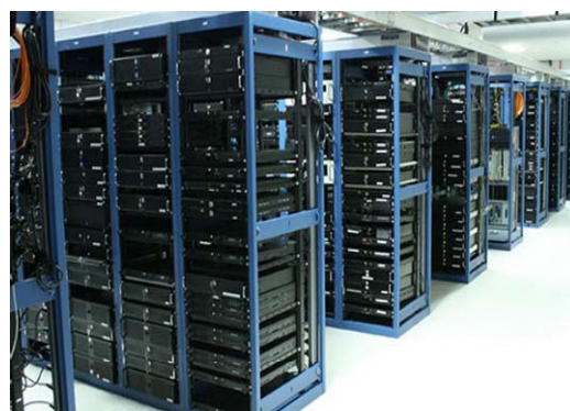
上海呼兰数据中心
