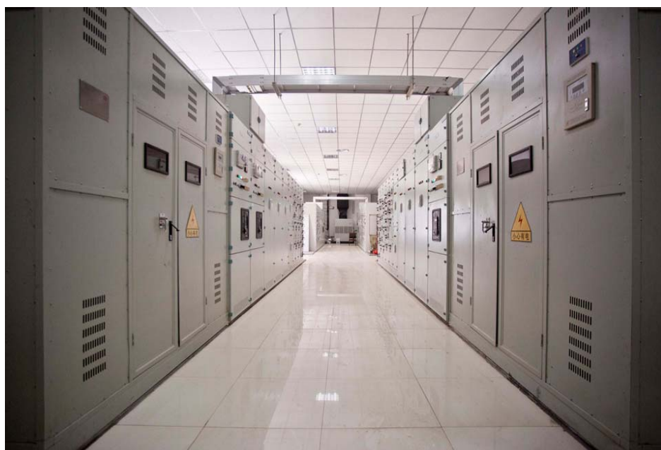
中天运营项目低压配电室
