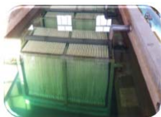
一期预处理运行中高强度膜池
